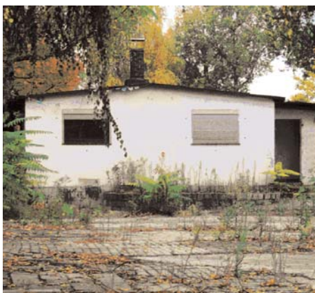
Das Gebäude der ehemaligen Kohlenhandlung von Julius Leber in Schöneberg soll gesichert werden. Foto: Möller / Jander
